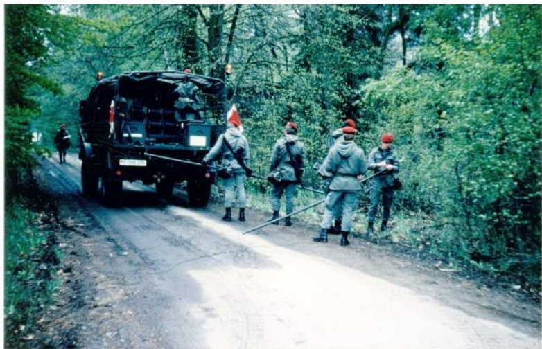
...der FmZug bei einer Übung. Hier verlegen von Feldkabel vom LKw 2 t.
